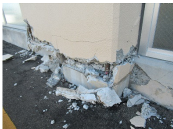
山元町内の RC 造建物の被害
