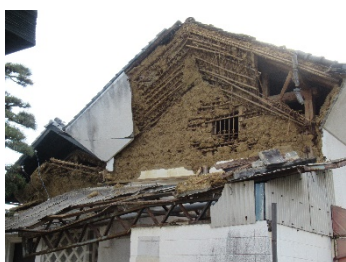
新地町内の土蔵の被害
