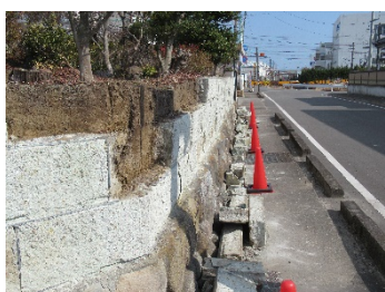
相馬市内の石塀の被害
